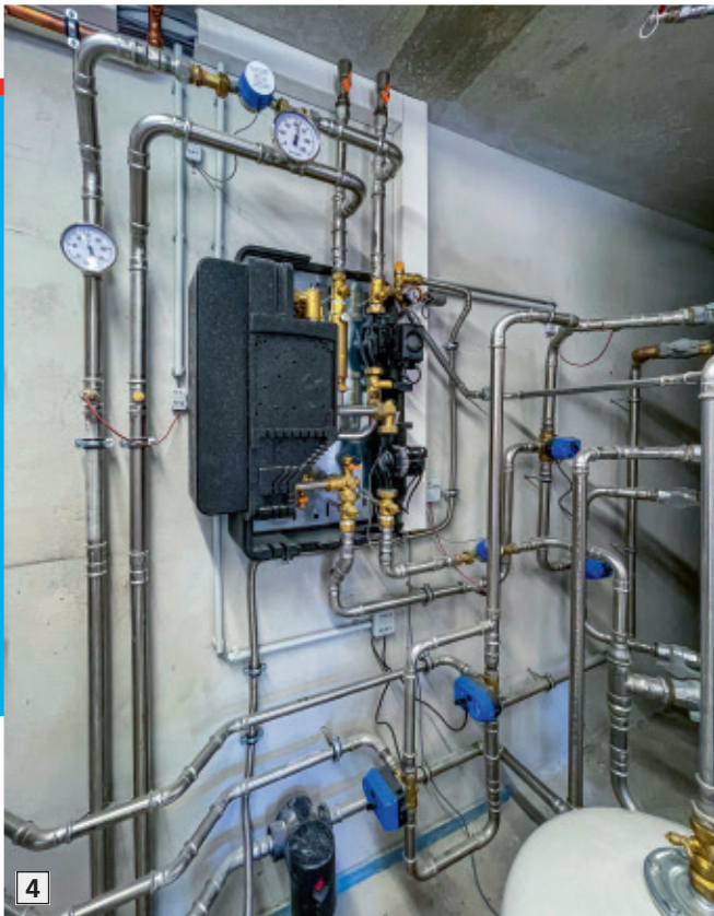
4 Technisches Detail im Haus Klävemann II mit PAW-„SolexMaxi“ zur Pufferspeicher-Beladung mit zwei drehzahleregelten Pumpen und Plattenwärmeübertrager als Systemtrennung (Wasser/Solarfluid), welche je nach Solarleistung über einen eigens dafür programmierten Regler modulierend angesteuert wird.
